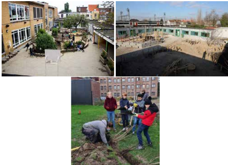
Figuur 7-23. Voorbeeld van onthardingsprojecten bij scholen (Linksboven : De Bever in Antwerpen, Rechtsboven : Basisschool Sint- Paulus in Kortrijk ) en plantdag op de Montessorri school i.k.v. traject “weg met grijze speelplaatsen” van de initiatief “plan vandaag” van de Provincie Antwerpen (Onder; bron: Provincie Antwerpen, 2022)
