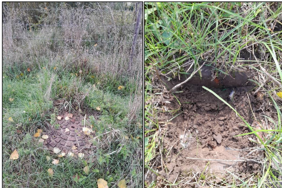
Figuur 7: Rioolput (links) en bouwpuin (rechts) op deelgebied 1. (ABO nv 2022)
