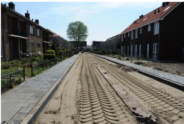
Zichtbare afvoer wegwater via molgoot in midden van de weg (foto Antal Zuurman)
